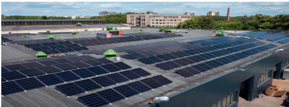
21 pav. saulės elektrinė.
